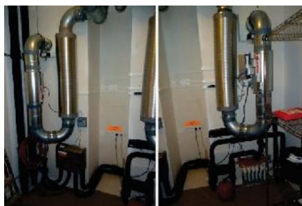
Slika 10 - Deo opreme sistema ventilacije i razdelnik grejanja i hla enja u ostavi stana stambeno-poslovne zgrade De Rotterdam u Roterdamu. Izvor: li na arhiva autora rada
