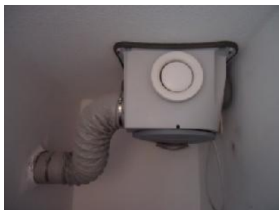
Slika 4 - Ventilatorska jedinica u ostavi stana, stambena zgrada Crescendo, Rotterdam, 2009. Izvor: li na arhiva autora rada
