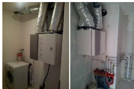
Slika 9 - WTW jedinica sa razdelnikom grejanja odnosno hla enja u ostavi stana, stambeno-poslovna zgrada Calypso u Roterdamu. Izvor: li na arhiva autora rada
