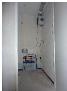
Slika 6 - Razdelnik grejanja/hlađenja i ventilatorska jedinica za odvod vazduha u ostavi stana, Stambeno-poslovna zgrada statendam u Rotterdamu, 2009. Izvor: li na arhiva autora rada
