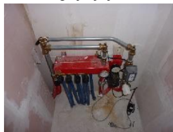
Slika 3 - Razdelnik grejanja u ostavi stana, stambena zgrada Crescendo u Roterdamu, 2009. Izvor: lična arhiva autora rada
