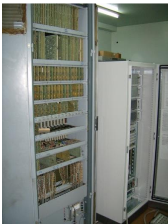
Slika 1 - Izgled telefonske centrale ETCE-60B koja je korišćena u TS Srbobran do 2007. god. (na slici levo) kada je zamenjena centralom ETCE-60D (desno)
