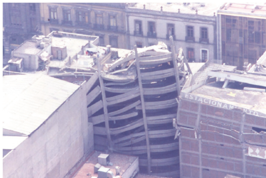
Слика 2. Лом префабриковане рамовске конструкције услед удара о суседне конструкције, Микоакан земљотрес, Мексико Сити, 1985. г. [1]
