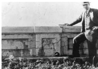
Слика 2. T.Stanton код АБ паранетног зида моста оштећеног услед АСР, Калифорнија ( State Division of Highways ), [8]
