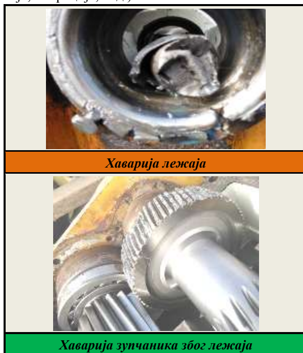
Слика 6 - Хаварија елемената редуктора
