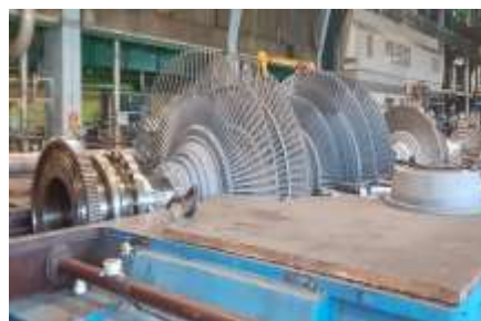
Slika 1 - Otvorena parna turbina bloka 200 MW
