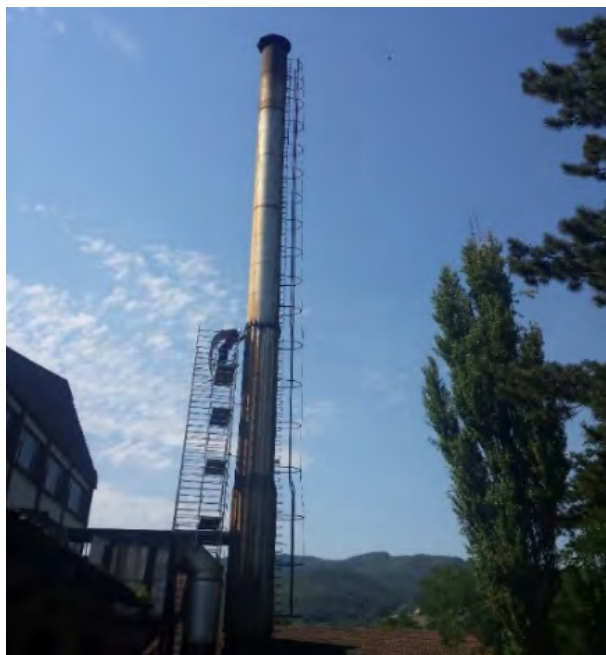
Slika 5: Emiter kotla – metalni dimnjak [7]
