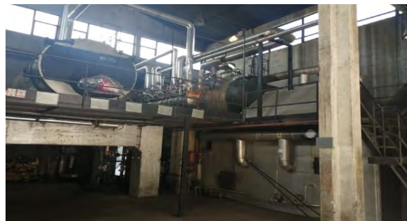
Slika 4: Kotlovi u postrojenju za proizvodnju tehnološke pare kotlarnici [7]
