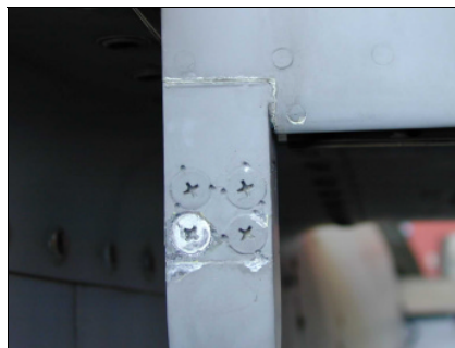
Slika 14 – Galvanska korozija na MB-339 između nosača od Mg legure i zavrtnja od aluminijuma Рус. 14 – Гальваническая коррозия на MB-339 между опорой из Mg сплава и алюминиевыми заклепками Figure 14 – Galvanic corrosion on the MB-339 between an Mg alloy trim and aluminum rivets
