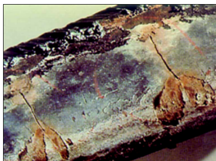
Slika 20 – Transkristalna prskotina nastala kao posledica naponske korozije (oštra je i prava) Puc. 20 – Трещина в результате коррозионного напряжения. Острая трещина с ровными краями. Транскристаллитная трещина Figure 20 – Crack as a result of stress corrosion. The crack is sharp and straight – transgranular crack
