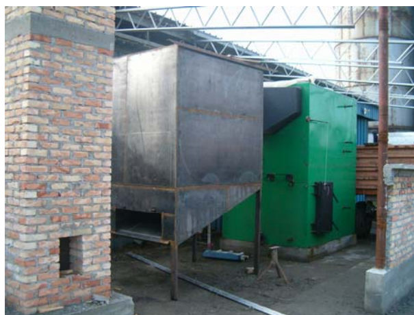
Sl. 2. Kotao termičke snage 300 kW sa taložnikom pepela i dimnjakom, proizvođača "Eko produkt" u Novom Sadu
