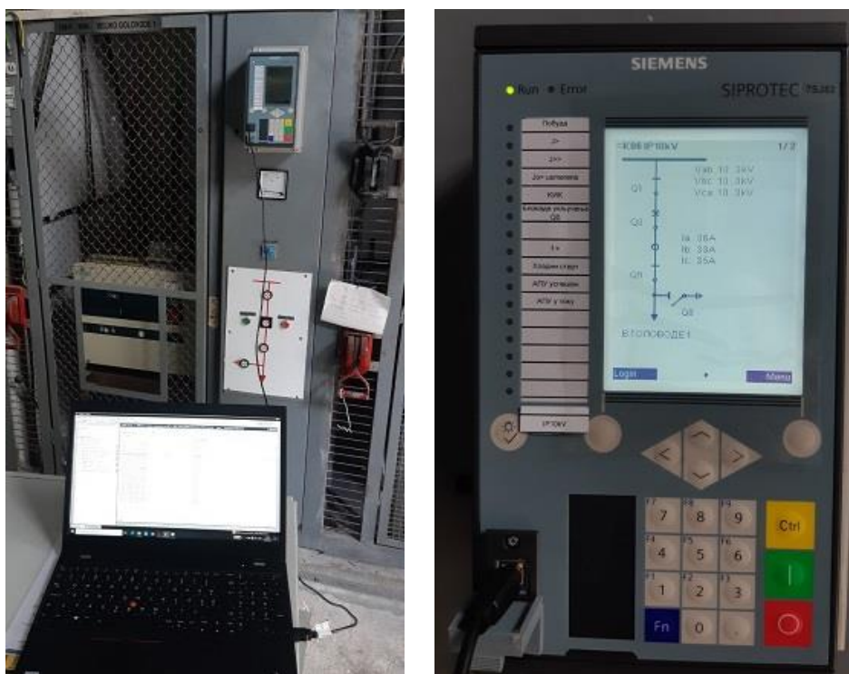
SI. 12. Izvodna ćelija i zaštitni relej SIEMENS - analiza događaja
