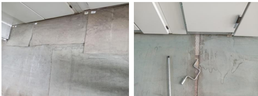
Sl. 5. Primeri nepravilnog postavljanja elektrizacionih prostirki u TS 35/10 kV
