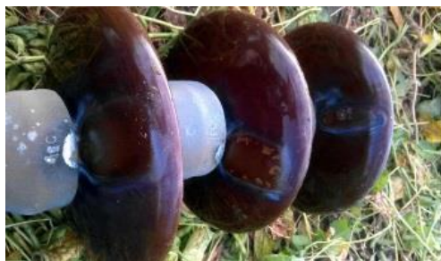
Sl. 3. Izolator nakon preskoka
