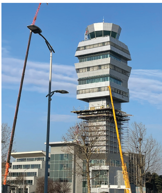
Сл. 10. Торњ контроле лета у фази изградње, март 2022 (извор: аутори) 4 Fig. 10. Flight Control Tower under construction, March 2022 (source: Authors)
