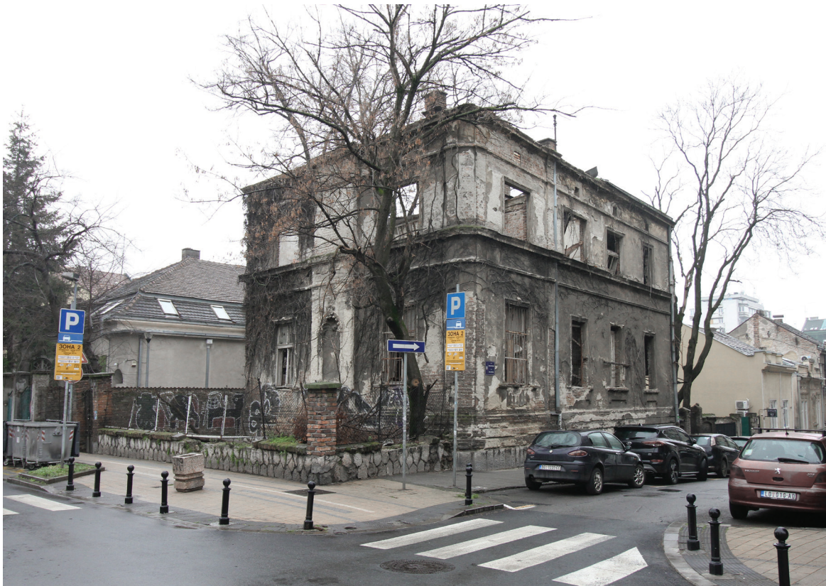
Сл. 10. Кућа Драгића Павловића, данашњи изглед / Fig. 10. House of Dragić Pavlović, present day appearance
