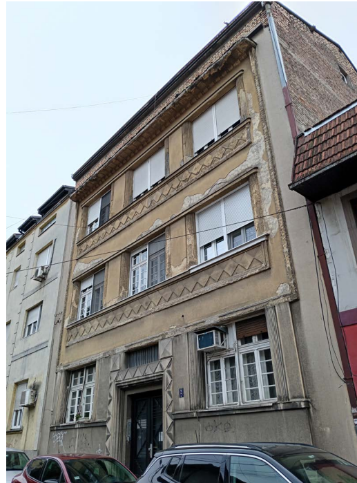
Сл. 5. Прејављен пројекат фасаде у Нишкој 2, 1930. (извор: ИАБ, ФТД, ФХ-20-1930) и стање на терену септембра 2024. (фотографија: А. Новаковић)
