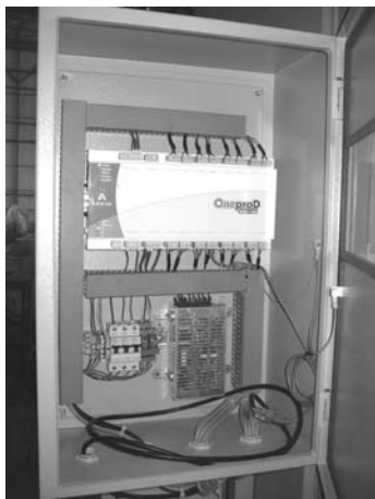
SI 5. OneproD MVX sistem za online praćenje vibracija, proizvođač 01dB-Metravib, Instalacija u TETO – Novi Sad
