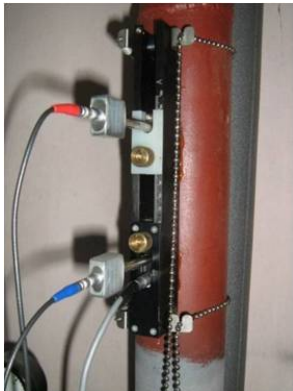
Fig. 3. Ultrasonic flow meter
