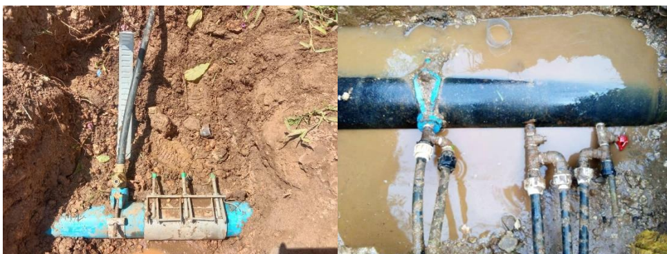
Slika 5 i 6. Popravka detektovanih curenja
