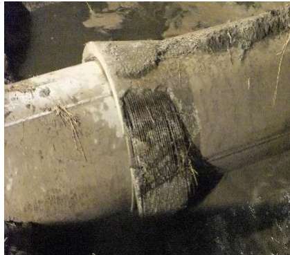
Слика 8. Оштећење бетонске цеви \phi 1000 Figure 8. Damage to concrete pipe \phi 1000
