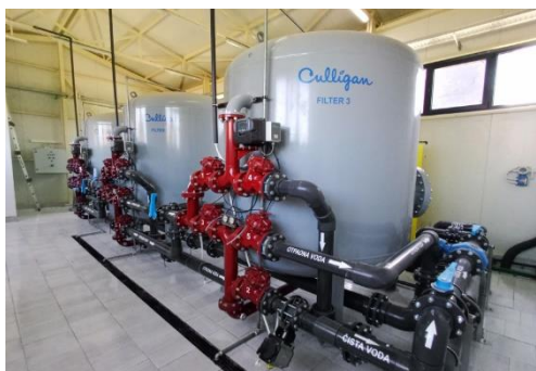
Slika 7. Fabrika vode Bački Monoštor Figure 7. Bački Monoštor Water Factory
