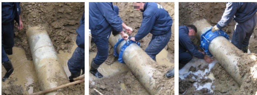
Слика 3. Санација пуцања цеви DN350 (Водовод Топола, фебруар 2013) Figure 3. Repairing rupture of DN350 pipe (Topola Waterworks, February 2013)
