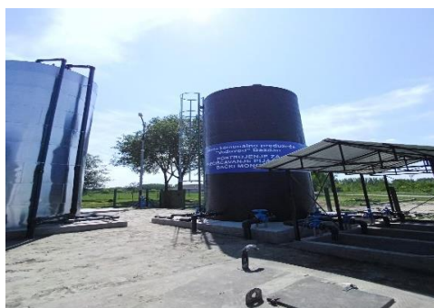
Slika 8. Fabrika vode Bački Monoštor Figure 8. Bački Monoštor Water Factory
