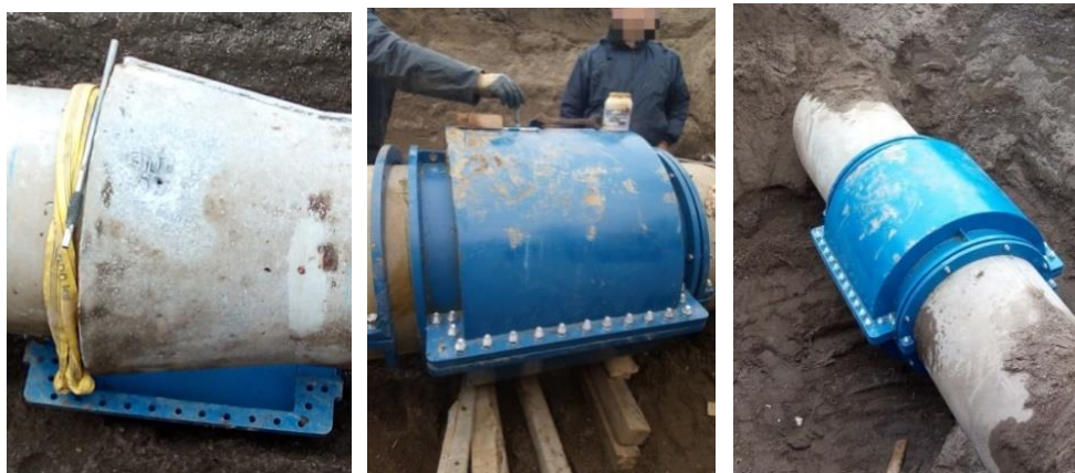
Слика 7. Санација оштећења цеви DN600 на споју (Водовод Крушевац, март 2019)
