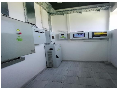
Slika 9. Fabrika vode Bački Monoštor Figure 9. Bački Monoštor Water Factory
