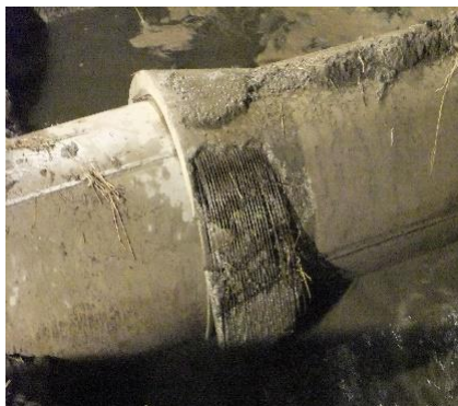
Слика 8. Оштећење бетонске цеви \phi 1000 Figure 8. Damage to concrete pipe \phi 1000
